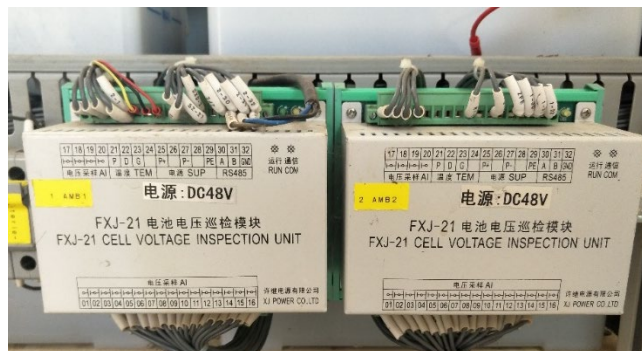
Figure 4: Unités d'inspection de la tension des batteries
